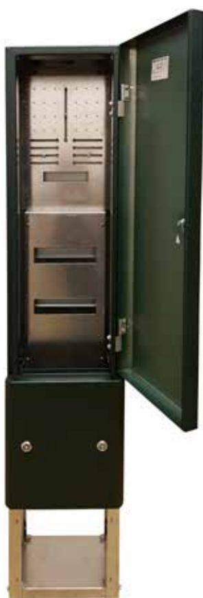
Koblingsskap med plass til 1 måler
